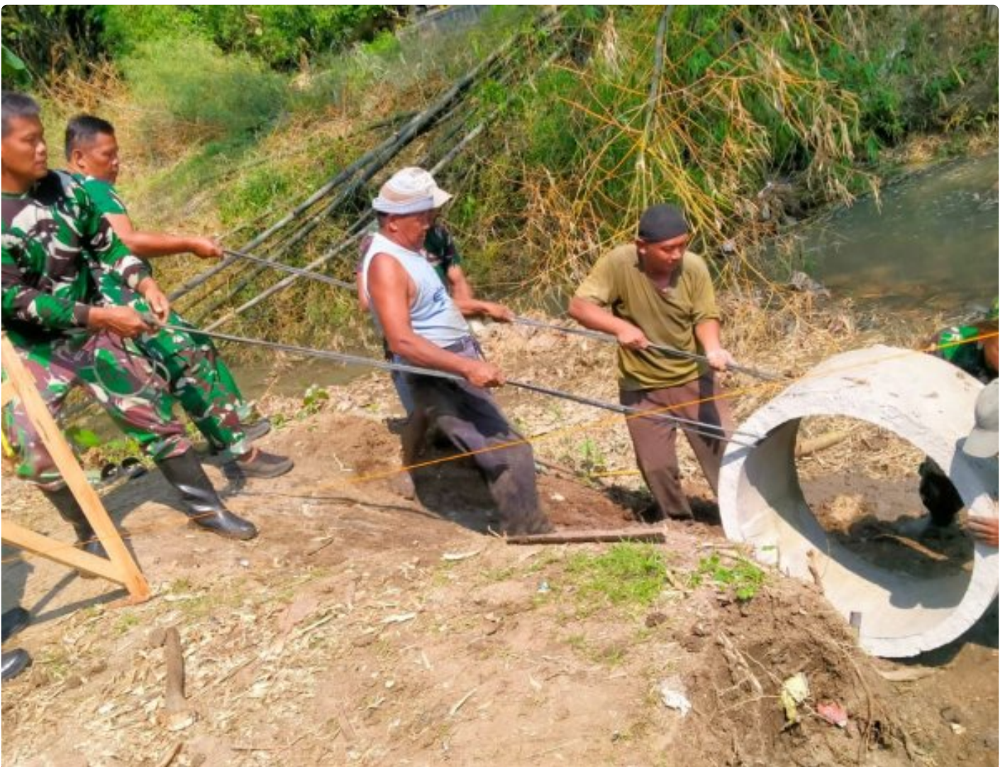
Semangat Gotong Royong Warga Warnai Pemasangan Bis Beton Jembatan Garuda Desa Burikan
